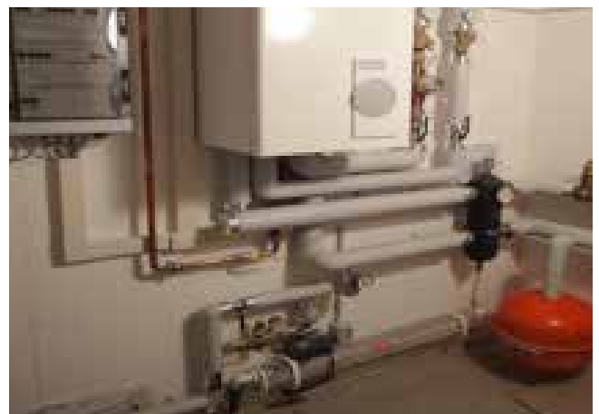
LOCALE CENTRALE TERMICA
