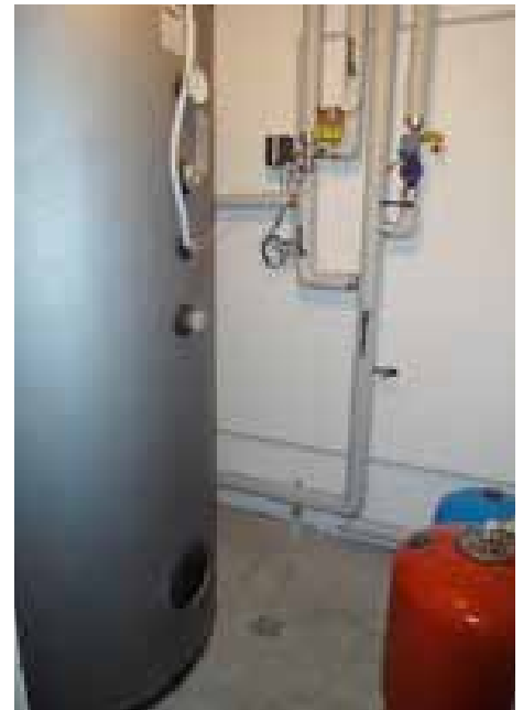
BOILER DI ACUMULO
