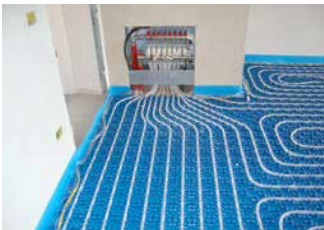
RISCALDAMENTO A PAVIMENTO
